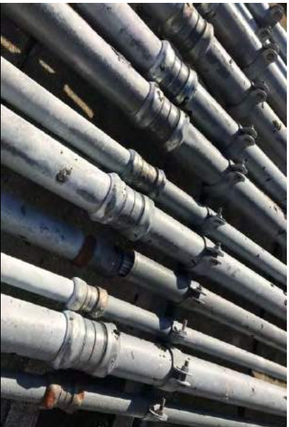
#67 OPEN ELECTRICAL CONDUIT
