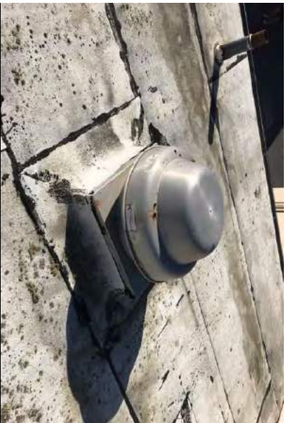
#55 BROKEN CENTRIFUGAL EXHAUST FAN
