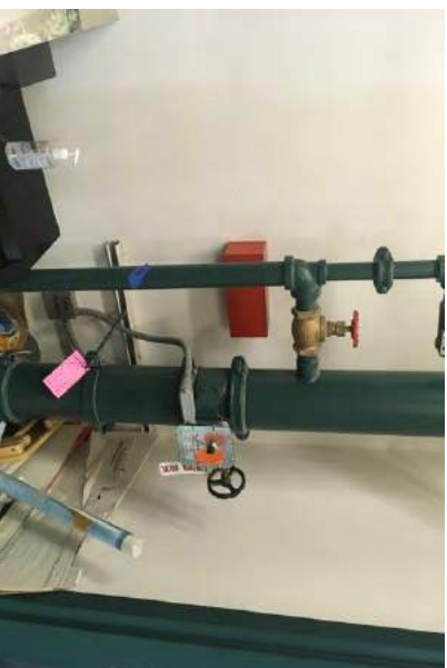
#46 FIRE SPRINKLER STAND PIPE
