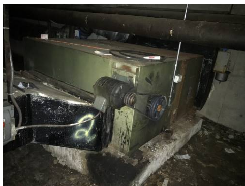
Crawlspace – HV Unit
