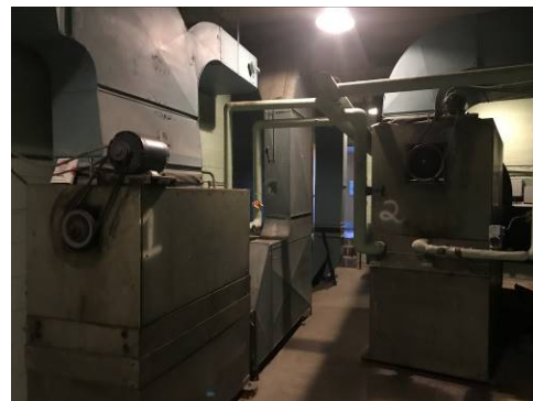
Auditorium HV Unit and Exhaust Fan
