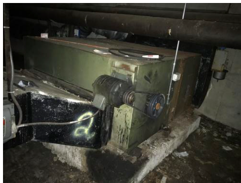
Crawlspace – HV Unit
