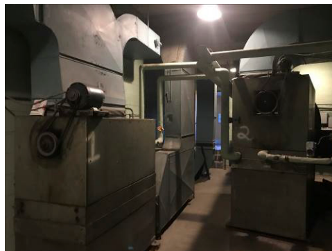
Auditorium HV Unit and Exhaust Fan
